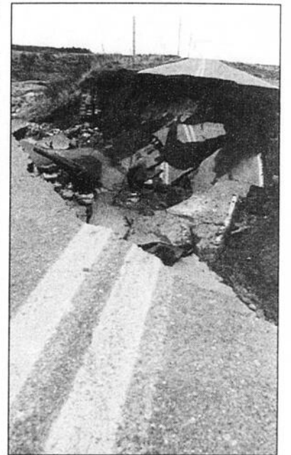
PLUIES — Sur la photo, on aperçoit une partie de route entre Yamachiche et Saint-Sévère, qui a été sectionnée à la suite des pluies abondantes de la fin de semaine dernière.
