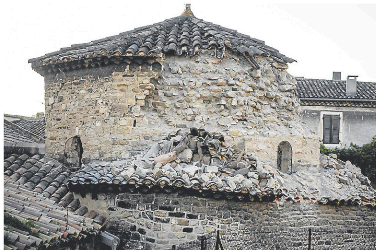
À Le Teil, une partie de la tour d'une église s'est effondrée lors du tremblement de terre qui a frappé la région, lundi. — PHOTO AFP, JEFF PACHOUD
