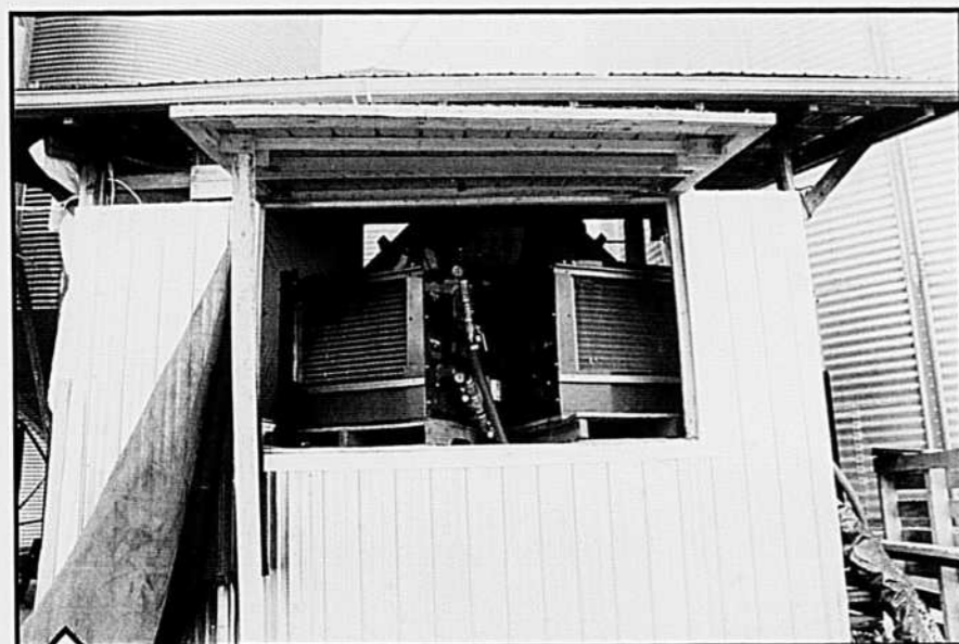
La chaufferie de Sequoia développe 3 000 000 de BTU par chargement de billes pouvant mesurer jusqu'à 55 po de longueur.
