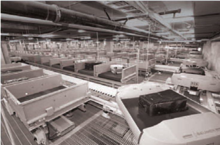
Léonard Infrastructures de transport Système de manutention de bagages au nouveau secteur des départs transfrontaliers, Aéroport Pierre-Elliott-Trudeau
