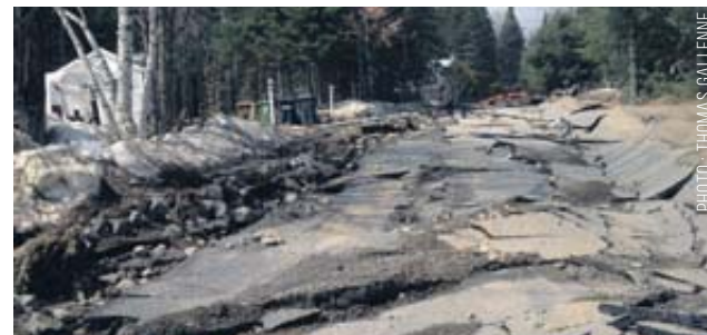
L'écoulement de l'eau a aussi fait des dégâts sur les infrastructures. Ici, la montée du 8 e rang dans le secteur du lac Paquin à Val-David. Selon les riverains, cette rue avait été refaite il y a trois ans. PHOTO : THOMAS GALLENNE
