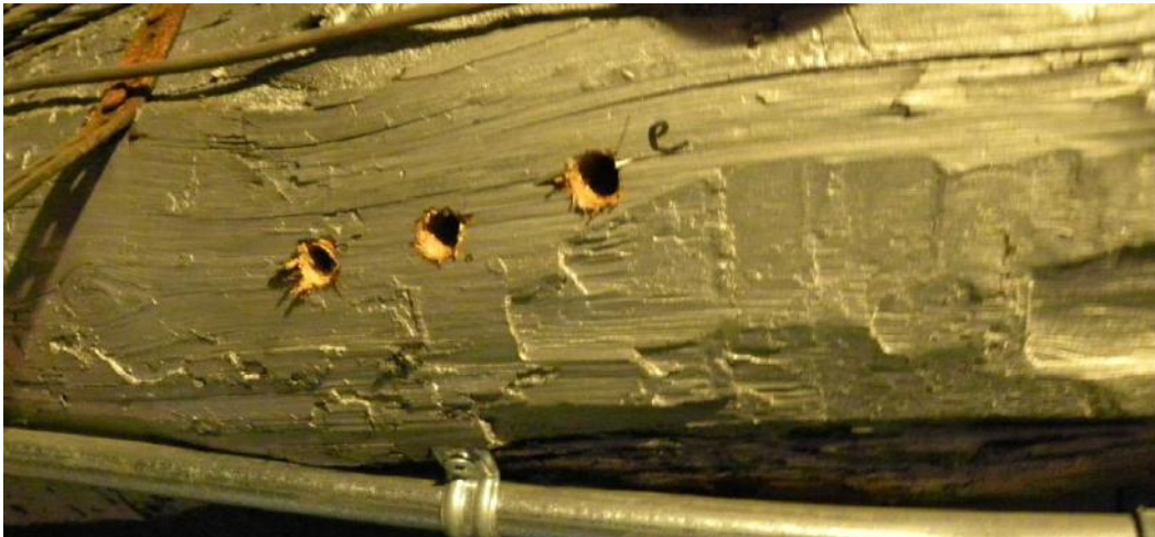
Photo 5. Surface légèrement écharrie de la poutre 23A150e et position des carottes prélevées.
