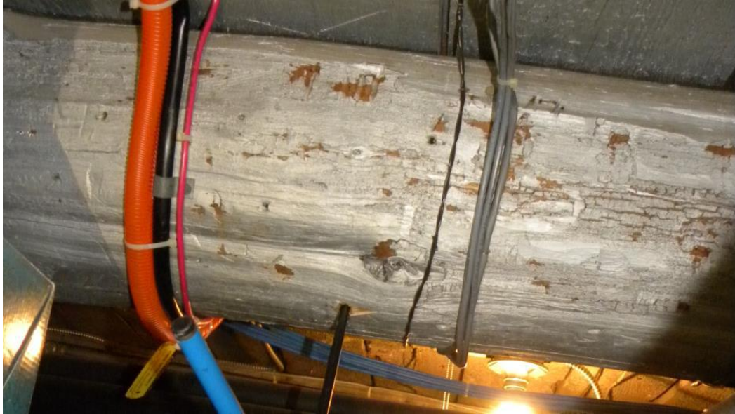
Photo 4. Surface relativement lisse de la poutre 23A150d .
