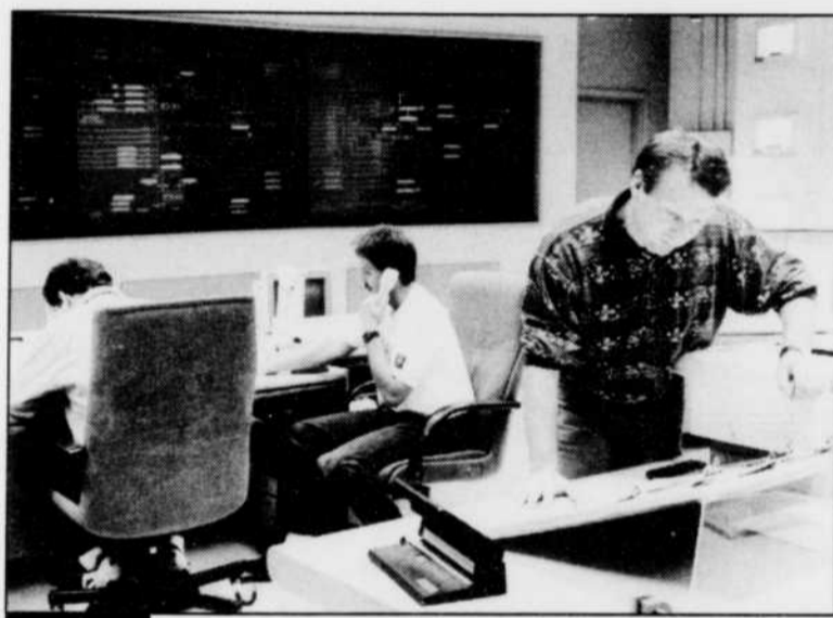
Le Centre de conduite du réseau est en quelque sorte le cœur de tout le réseau hydroélectrique d'Alcan. C'est là que toutes les informations se rendent et que les décisions sont prises. Le tableau synoptique, qui donne une excellente vue d'ensemble du réseau, est évidemment un outil indispensable pour Jérôme Larouche, surveillant-opérations par intérim, ainsi que Patrice Tremblay et Daniel Tremblay.
