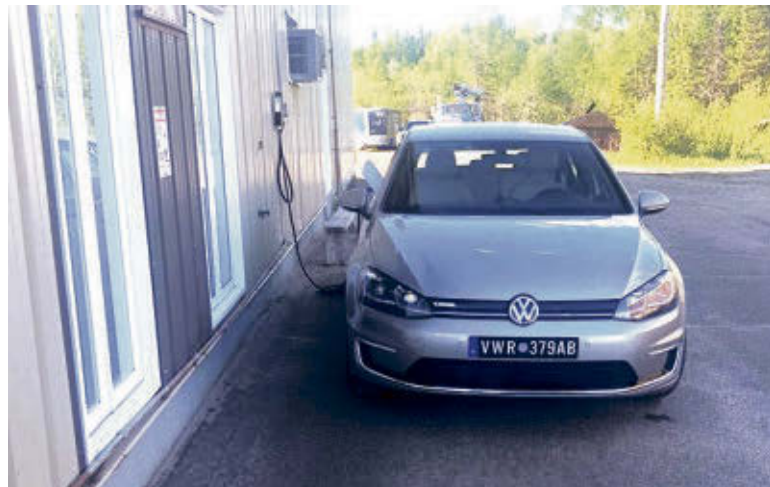
La borne de recharge est accessible à quiconque possède une voiture électrique. (Photo : courtoisie)
