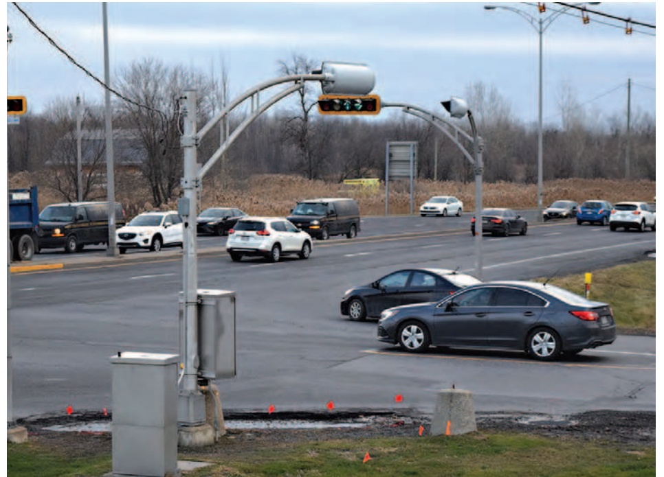
Les travaux de l'intersection de la carrière et de la route 112 devraient se faire à l'été 2021. (Photo : courtoisie)
