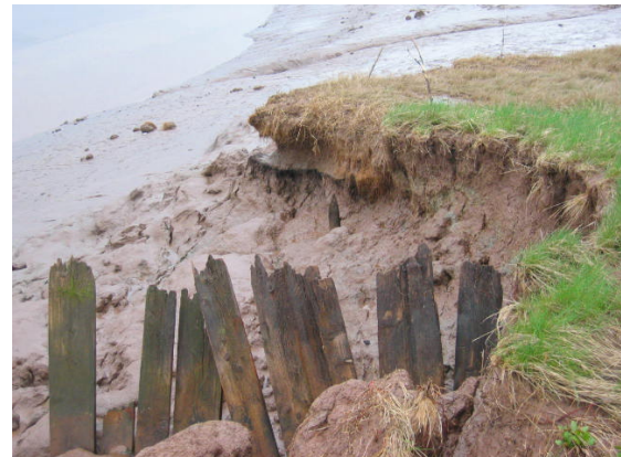
Figure 3 : Érosion d'une digue (aboteau) sur la baie de Fundy. Source : Collection de l'auteur, 2006. Source : Thomas William Downes, 1938. Wellington : Alexander Turnbull Library, A-076-012.
