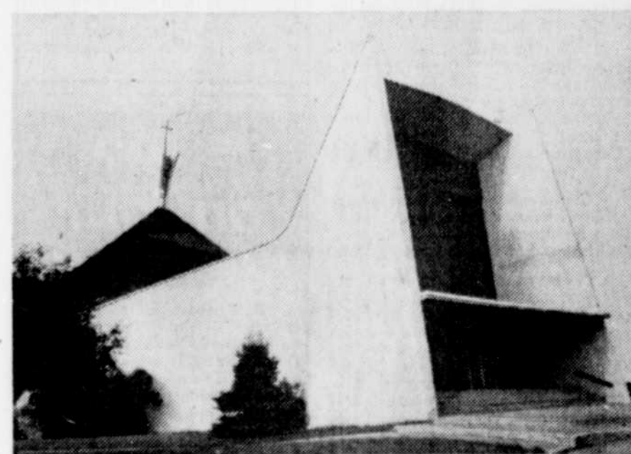
L'église de la paroisse Saint-Eugène exige des réparations importantes.
