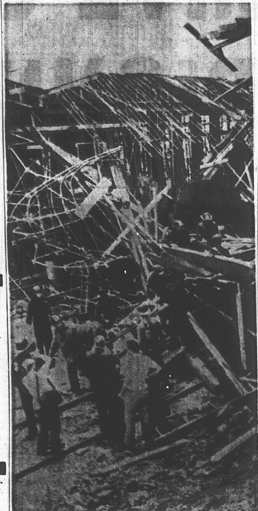
UN VIEUX PONT S'ECROULE — Un homme a été tué et cinq autres blessés quand un vieux pont s'est écroulé à Los Angeles. On était en train de le réparer. Le pont s'élève non loin du Freeway de San Bernardino.
