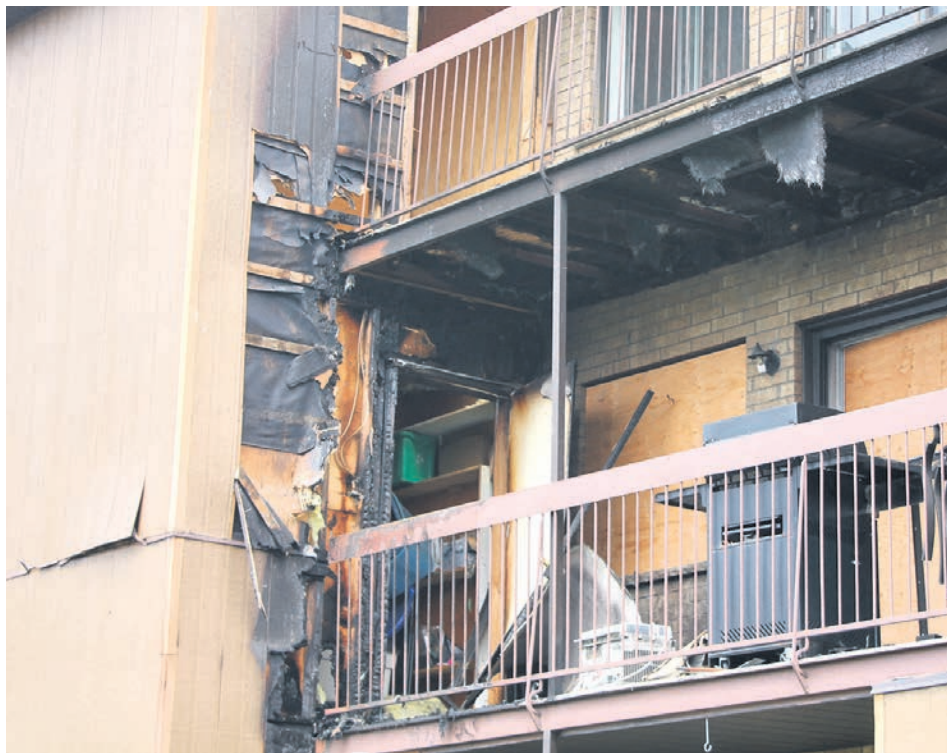
Le feu s'est déclaré sur le balcon du logement du 2 e étage. (Photo : Frank Jr Rodi)
