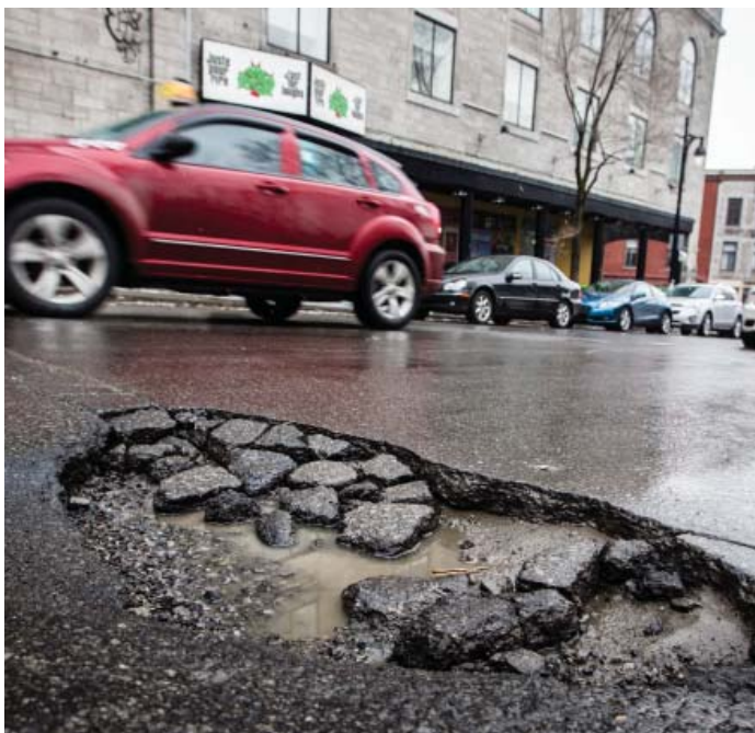
Nid-de-poule sur le boulevard Saint-Laurent, près de la rue Sherbrooke (25.02.2013) Crédit : © Dario Ayala, Montreal Gazette
