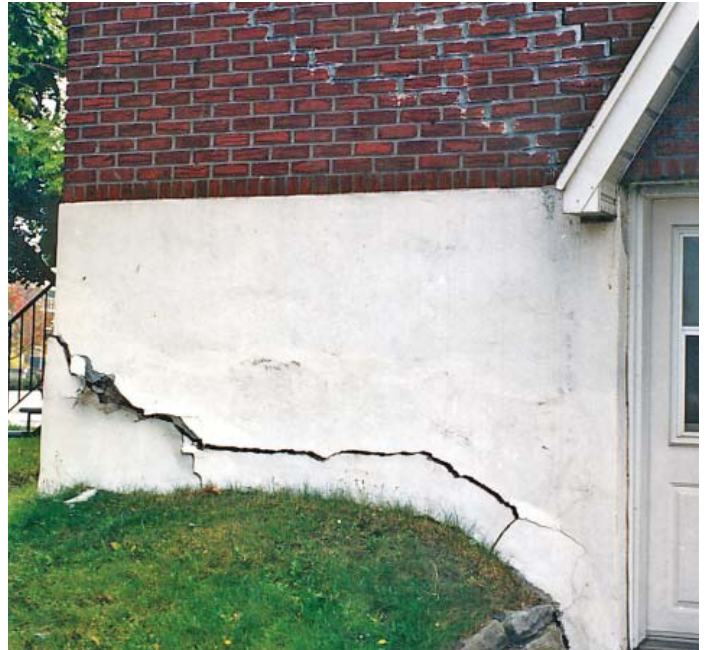
Fissures dans la fondation (lézardes) Crédit : © Ville de Montréal
