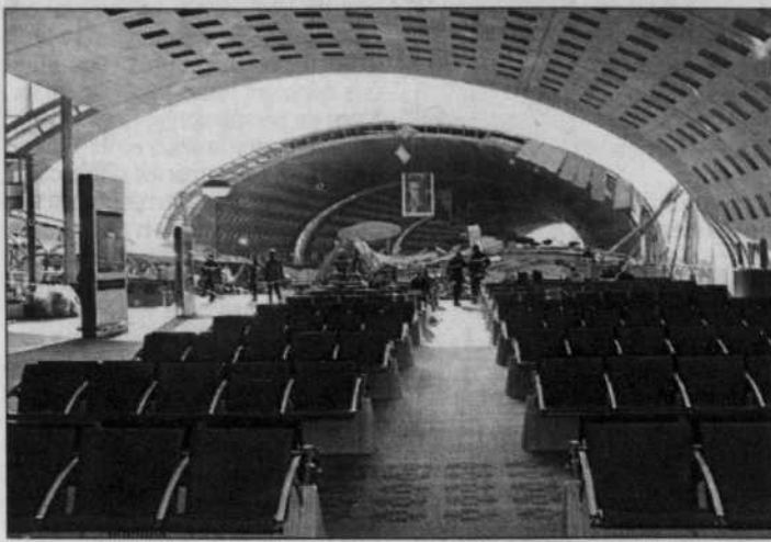
Des pompiers s'affairaient hier au fond de la salle d'embarquement du terminal 2E, dont une section d'une trentaine de mètres s'est effondrée dimanche. Ils ont dû plus tard évacuer l'endroit en raison de nouveaux craquements entendus dans la structure.
