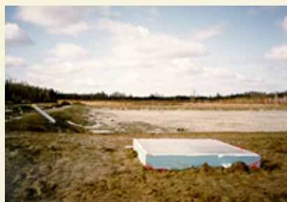
Un filtre biologique expérimental a été aménagé à l'exutoire pour traiter les eaux de drainage contaminées
