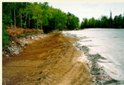
Une couverture multi-couches a été mise en place pour contrôler le drainage minier acide.
