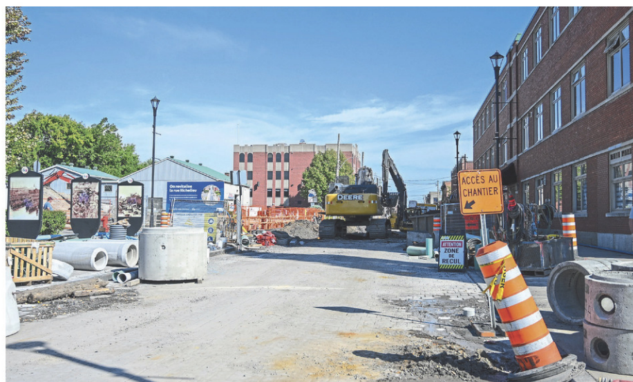
Les travaux sur la Richelieu se poursuivent entre les rues du Royal-22 e -Régiment et Saint-Georges.
