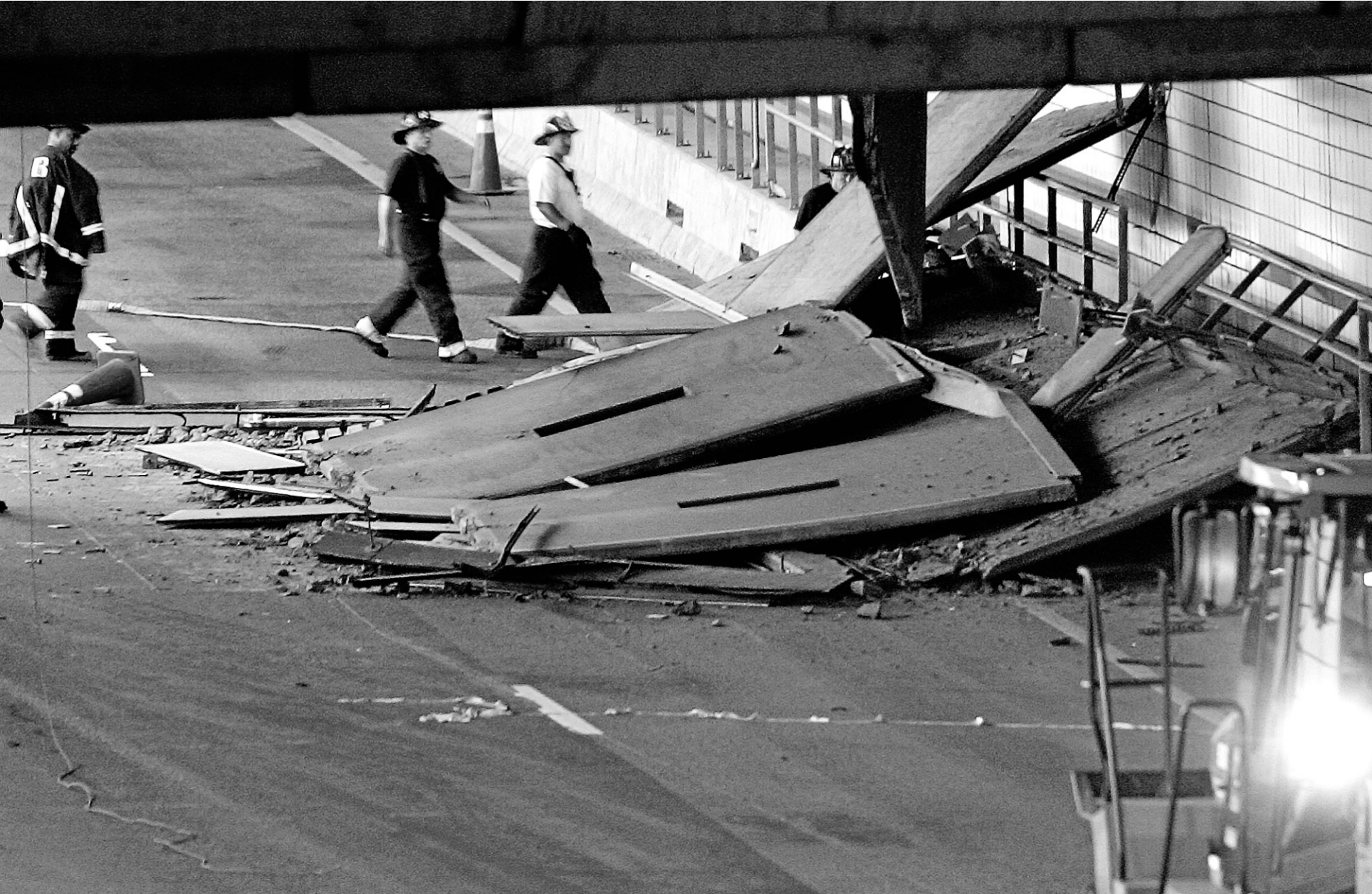
À Boston, un panneau de 3 tonnes a écrasé une voiture qui traversait le Central Artery Tunnel, en juillet 2006. L'entrepreneur l'avait mal collé au plafond. Peu après, les lampes du tunnel se sont mises à chuter.
