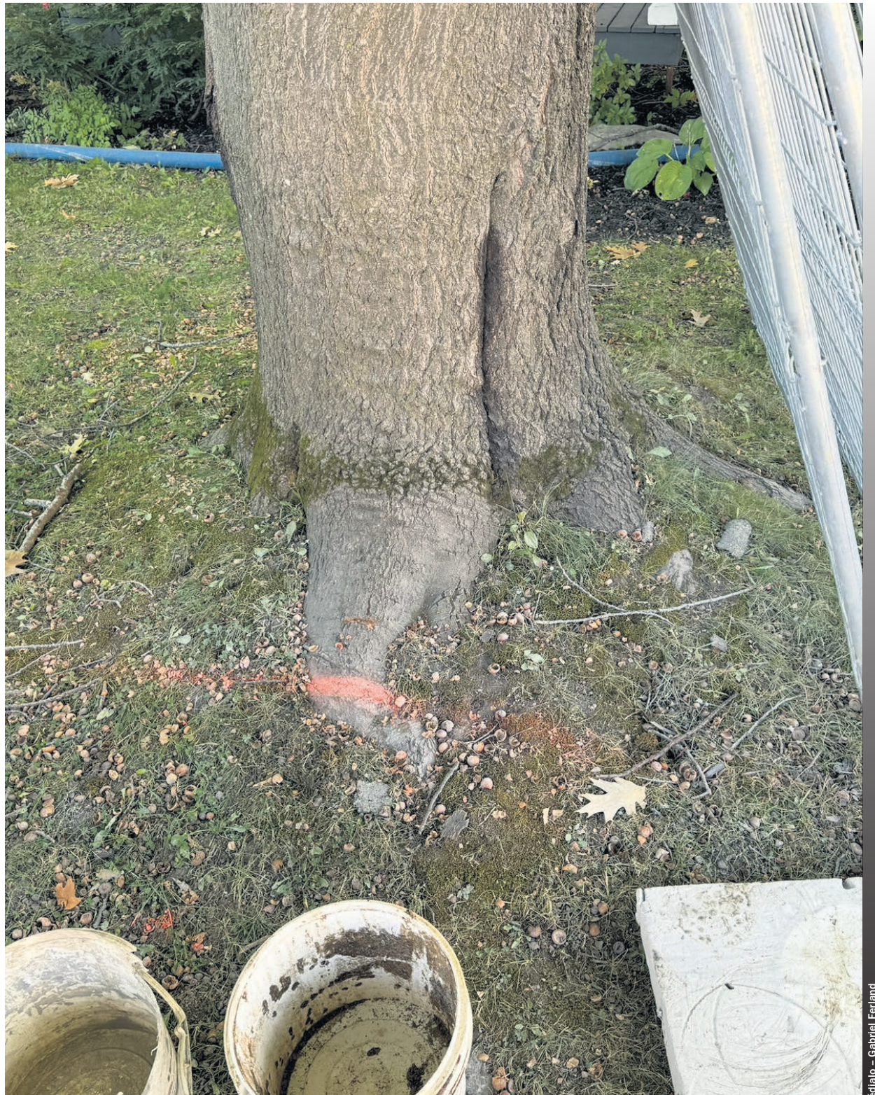
Marque au sol délimitant les travaux d'excavation au pied du chêne devant la résidence d'Élise Bergeron et Marc-André Brouillard.
