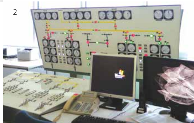
3. Armoire de commande de l'alternateur d'un des groupes de la centrale (1969). La plupart des composants des armoires de commande des alternateurs ont dû être changés, contrairement aux alternateurs eux-mêmes.
