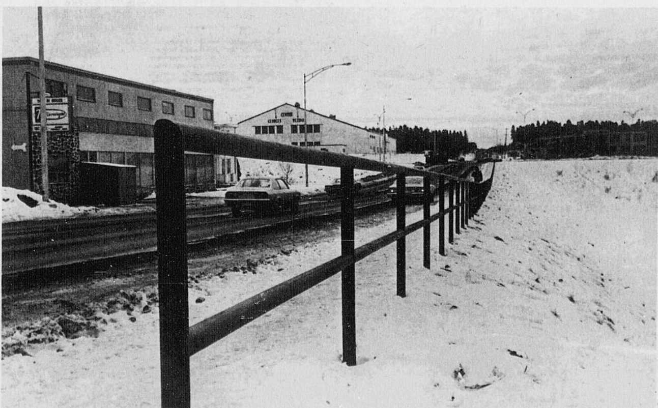
TRAVAUX — La rue Bégin avec le prolongement du boulevard St-Joseph à la hauteur du Centre Vézina a pris une allure d'un carrefour d'une grande ville. Des
