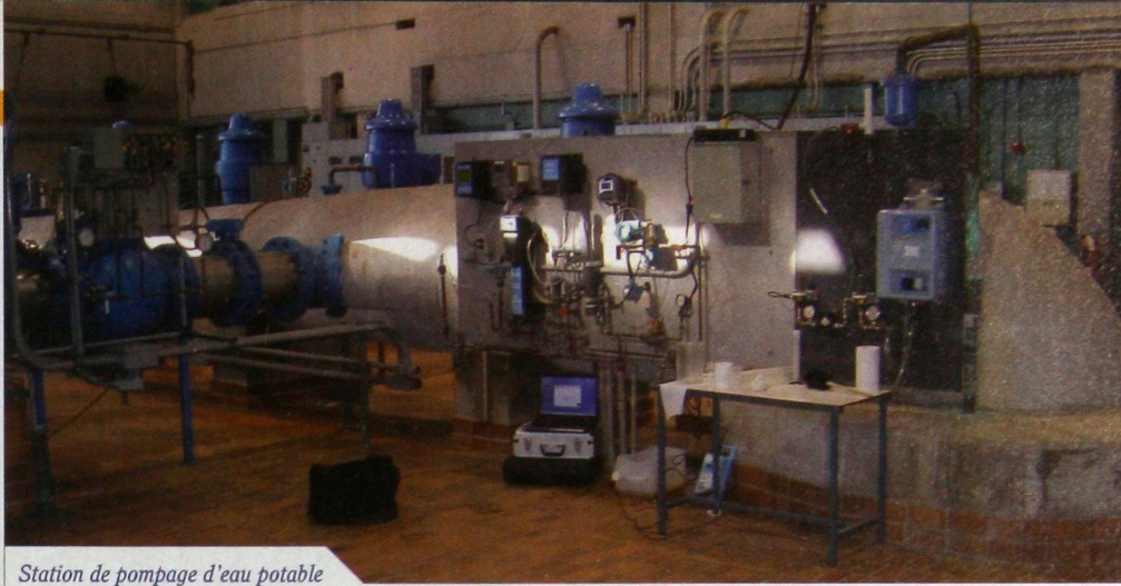
Station de pompage d'eau potable
