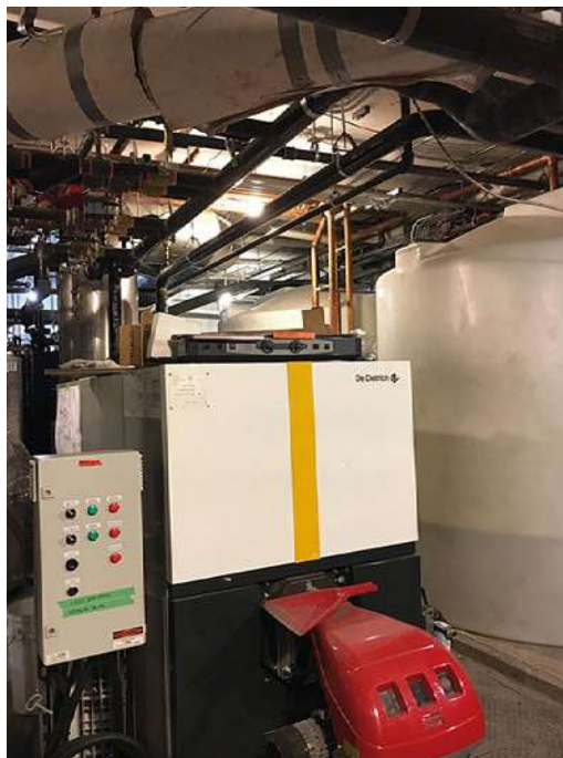
Chaudière à l'huile et réservoirs atmosphériques pour l'eau des laveuses de la buanderie
