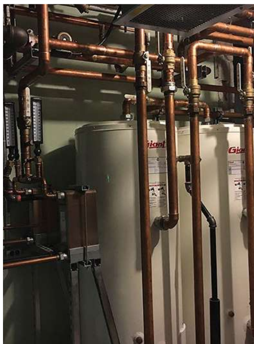
Nouveau système de production d'eau chaude domestique
