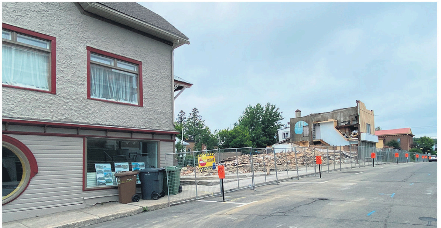
Les bâtiments ont tous été démolis les 5 et 6 juillet. (Photo L'info du Nord – André Chevrier)
