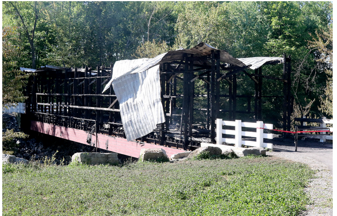
Le pont Brabant-Philippe a complètement brûlé en 2011. La structure a été attaquée à nouveau en 2015 après sa réouverture, mais il avait tenu le coup. Ce mois-ci, deux incendies y ont été allumés. — PATRICK WOODBURY, LEDROIT
