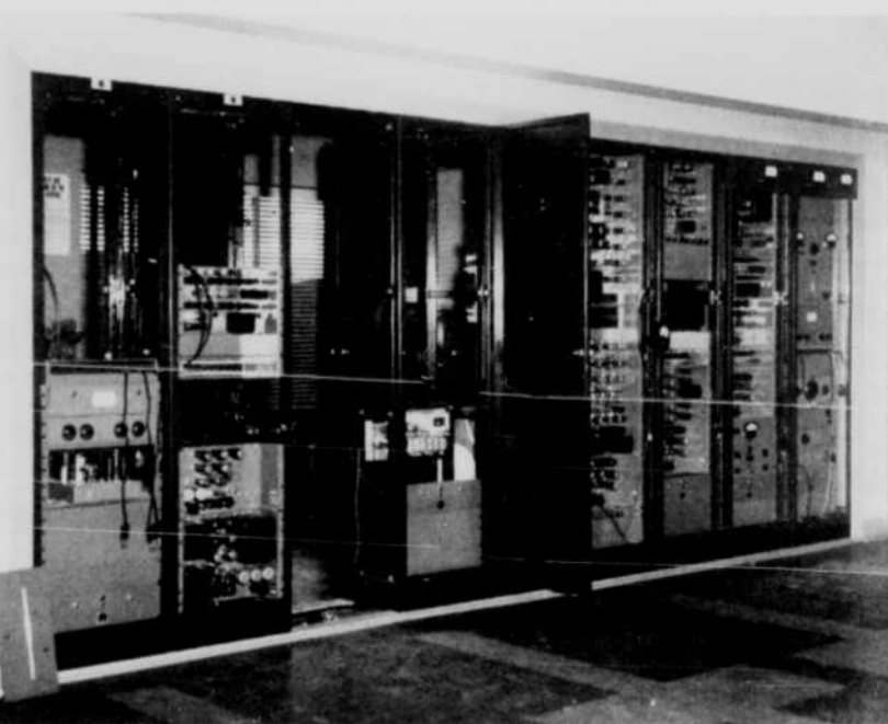
Au delà de 12.000 tubes électroniques... description mathématique de l'équipement des émetteurs sur le Mont-Royal. L'émetteur de CBFT amplifie 1.400.000 fois le signal reçu des studios pour atteindre la puissance requise.
