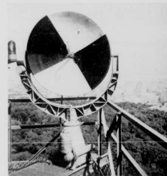
Voici l'un des trois récepteurs d'ondes métriques qui permettent de capter certaines émissions provenant des cars de reportage. Situés sur une galerie, à 120 pieds dans la tour du Mont-Royal, deux de ces récepteurs sont télécommandés de la salle de régie.
