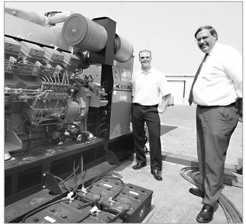
Bill McMillan, de GAL Power Systems, fait une démonstration des génératrices à Frank Medwenitsch, de l'Hôpital d'Ottawa.
