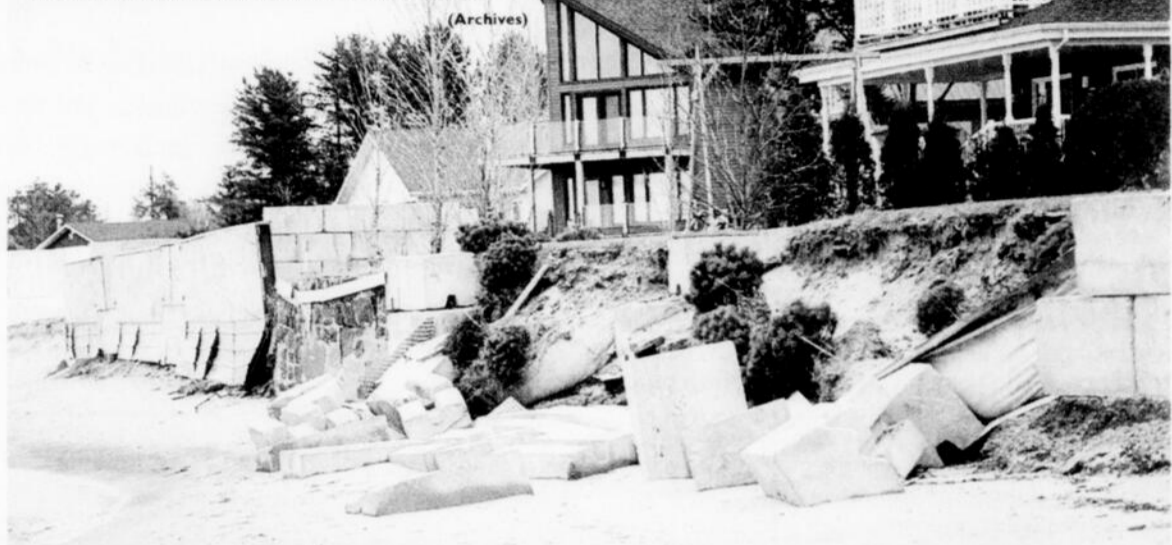
Les berges avaient été endommagées cet automne en raison du niveau élevé du lac Saint-Jean.
