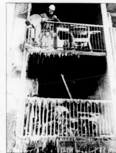
L'incendie a provoqué d'importants dommages.
