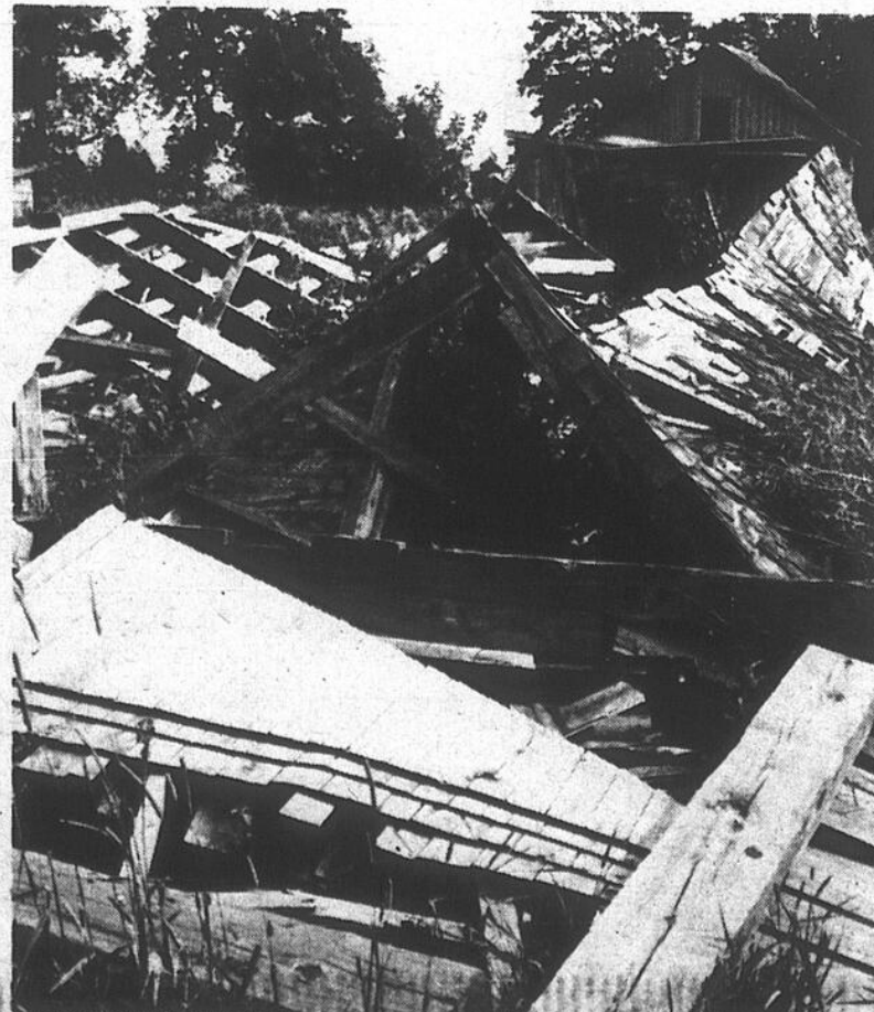
Tout ce qui reste du Village-de-la-Belle-Élodie: quelques bâtisses délabrées...
