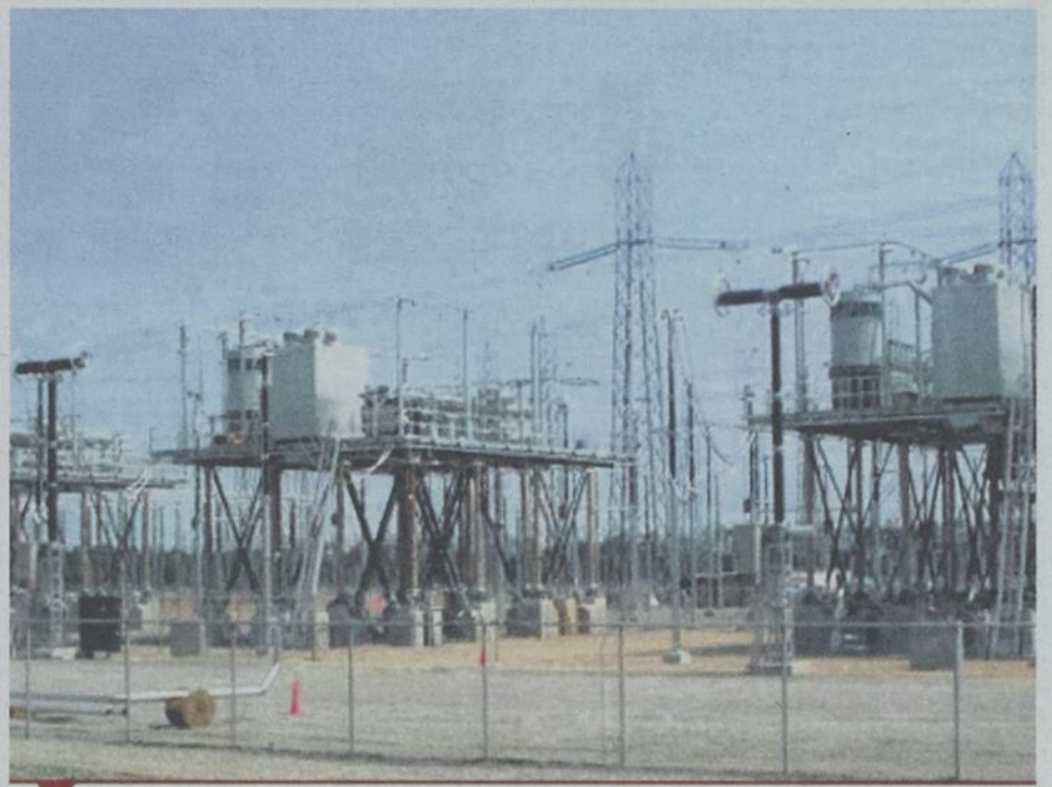
Le gouvernement libéral a donné son aval au projet de ligne haute tension à 735 kV de la Chamouchouane-Bout-de-l'Île, dont le tracé passera par les villes de Terrebonne et Mascouche.
