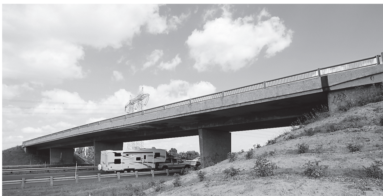
Des structures déjà examinées, plusieurs doivent subir des réparations majeures ou même être carrément remplacées.
