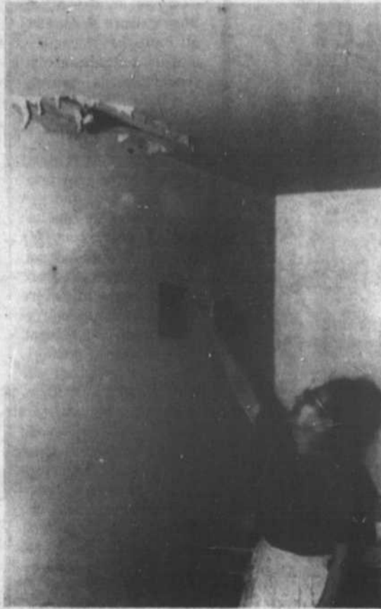
L'eau arrive par le plafond, glisse sur les murs et se répand en marre sur le plancher. (Photo Jacques Desfossés)
