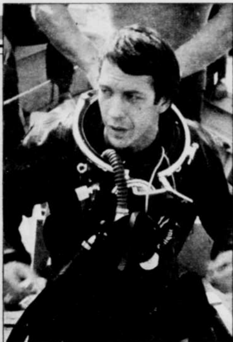
Chef d'équipe, Guillaume Tremblay installe avec ses hommes des conduites sous-marines et dynamite d'anciens barrages.
