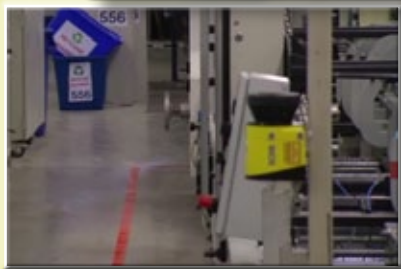
Les modules de détection des mouvements (laser à balayage) disposés au plafond et sur le côté de la colleuse détectent toute intrusion dans la zone d'alerte et la zone de sécurité.
