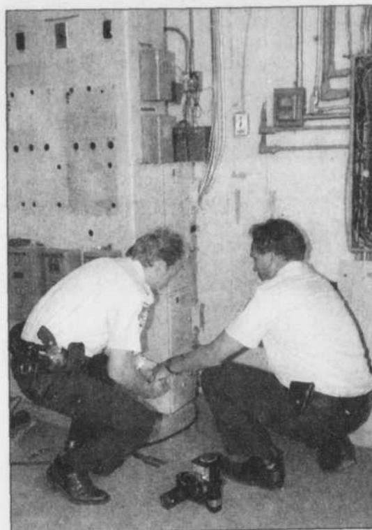
COLLABORATION SPÉCIALE, RENÉ MATHIEU C'est en manipulant des fils de cette boîte électrique que M. Blouin a reçu une décharge de 550 volts.
