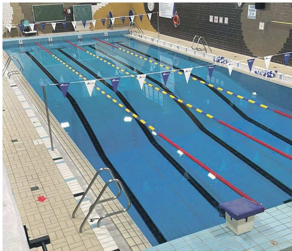
La piscine de Port-Cartier, qui a besoin de travaux majeurs. Photo courtoisie
