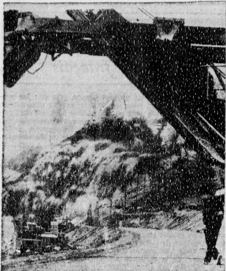
125.000 livres d'explosifs montent en fumée et détachent un demi-million de tonnes de pierre à chaux près de Jefferson-City (Tenn.). Cette pierre servira dans la construction de la grande digue de Cherokee. Il faudra 30 jours pour la transporter à la rivière Holston, qui n'est pas très loin de là pourtant.
