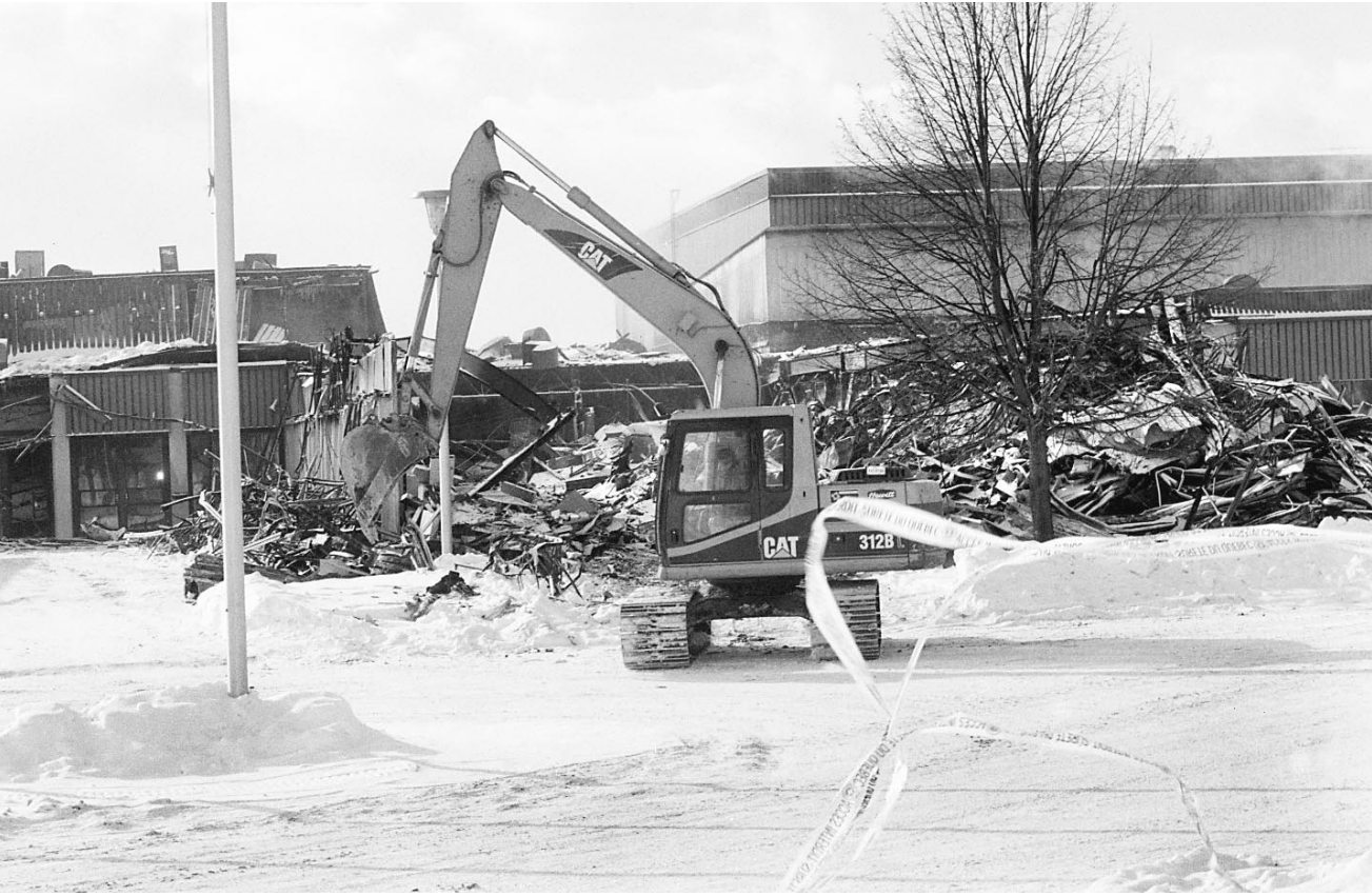
Le ménage des décombres de la polyvalente Pierre-de-Lestage continuait hier.
