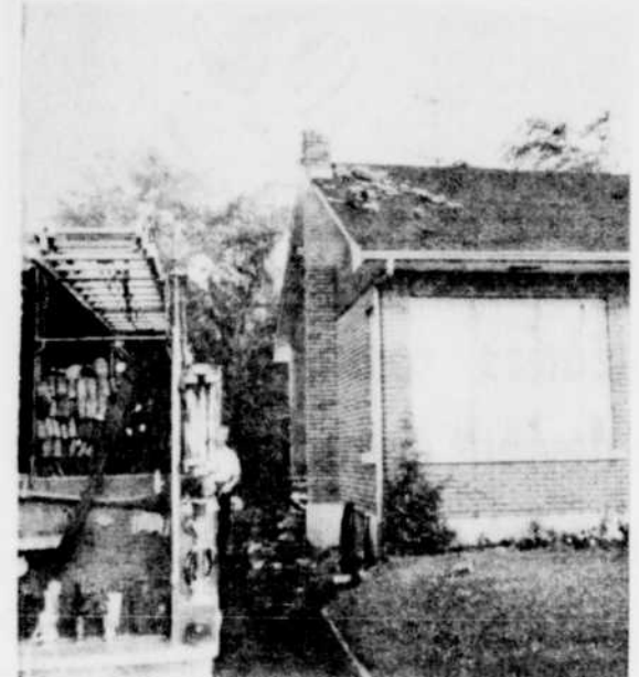
COUP DE TONNERRE — Le tonnerre a laissé des traces de son passage dans Windsor. En plus d'une panne générale d'électricité, une décharge électrique a causé deux incendies. Ci-haut, cette photo montre la cheminée de la résidence Paul Boudreau où le tonnerre a frappé la cheminée et allumé un début d'incendie. (Photo La Tribune, par André Therrien)
