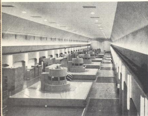
La centrale souterraine Bersimis I abrite, dans une caverne aux dimensions de cathédrale, huit groupes générateurs de 150,000 HP chacun.
