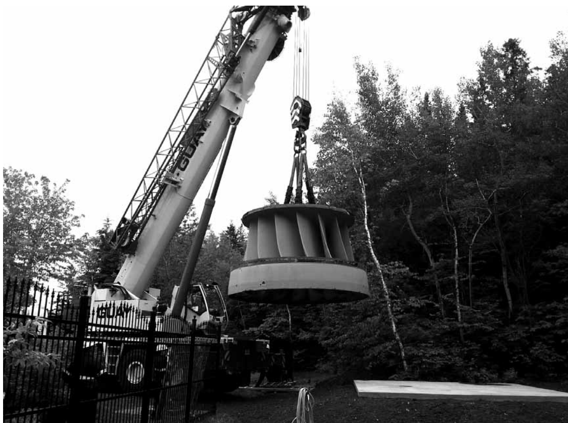
Installation de la turbine de type Francis, gracieuseté de Rio Tinto Alcan.
