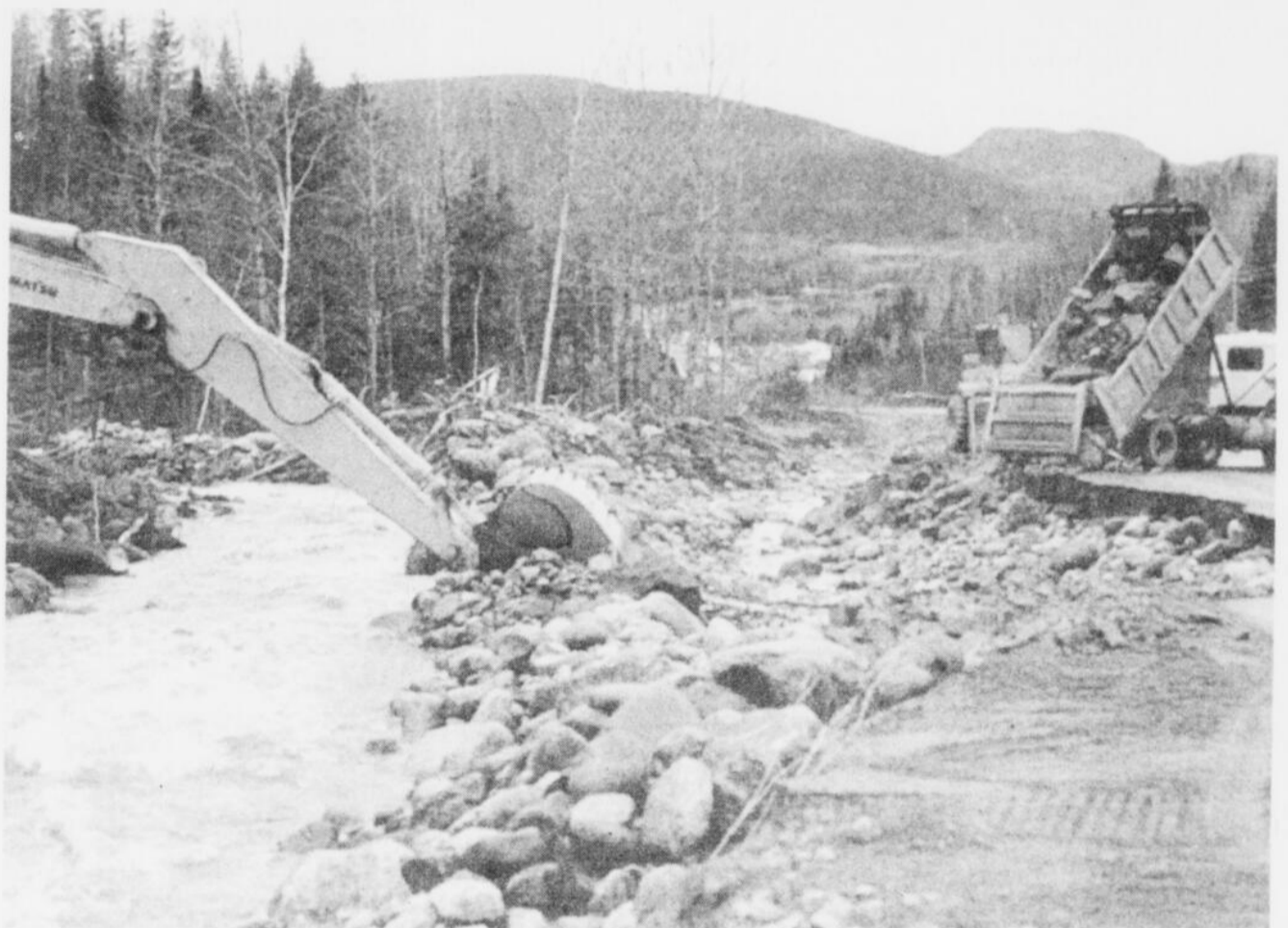
ENCORE - Fraichement refaite avant les gelées, cette côte menant à Petit-Saguenay a été partiellement détruite par les dernières pluies.
