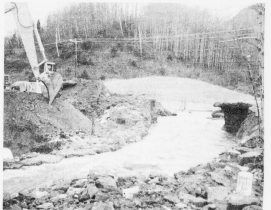
INCERTITUDE - Il faudra attendre quelques jours afin de voir si les travaux de reconstruction d'un pont sur la Cabanase ont résisté aux dernières pluies. Les infrastructures ont été submergées par la crue.
