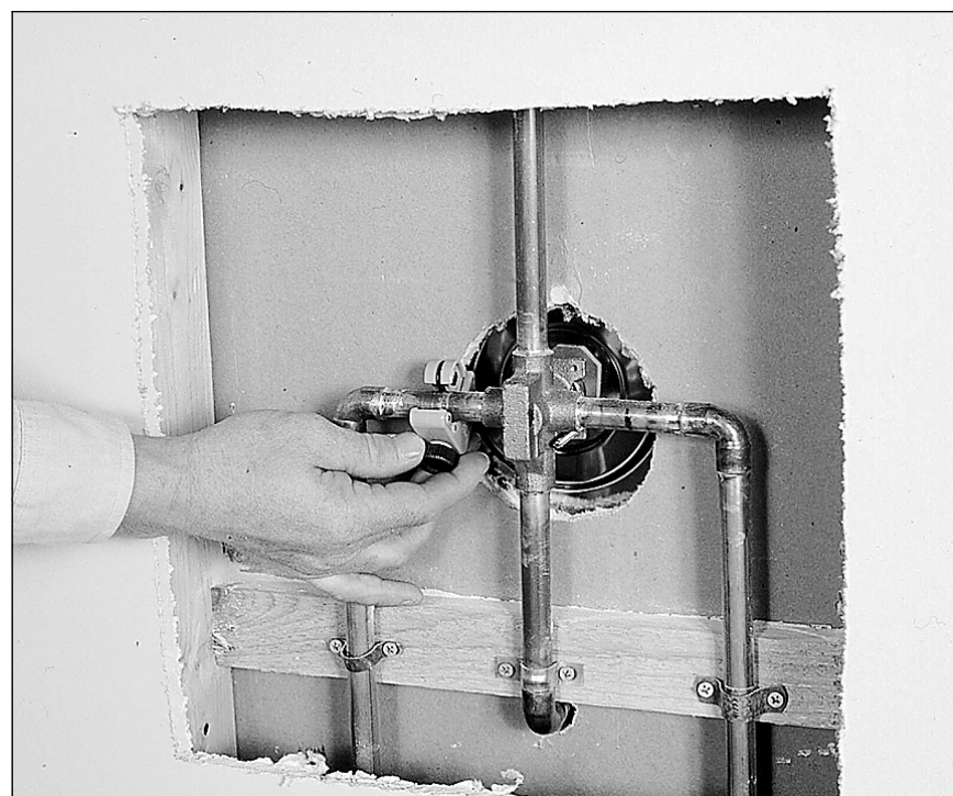
La plomberie de cuivre a fait ses preuves. Elle nécessite cependant l'intervention de mains expertes.
