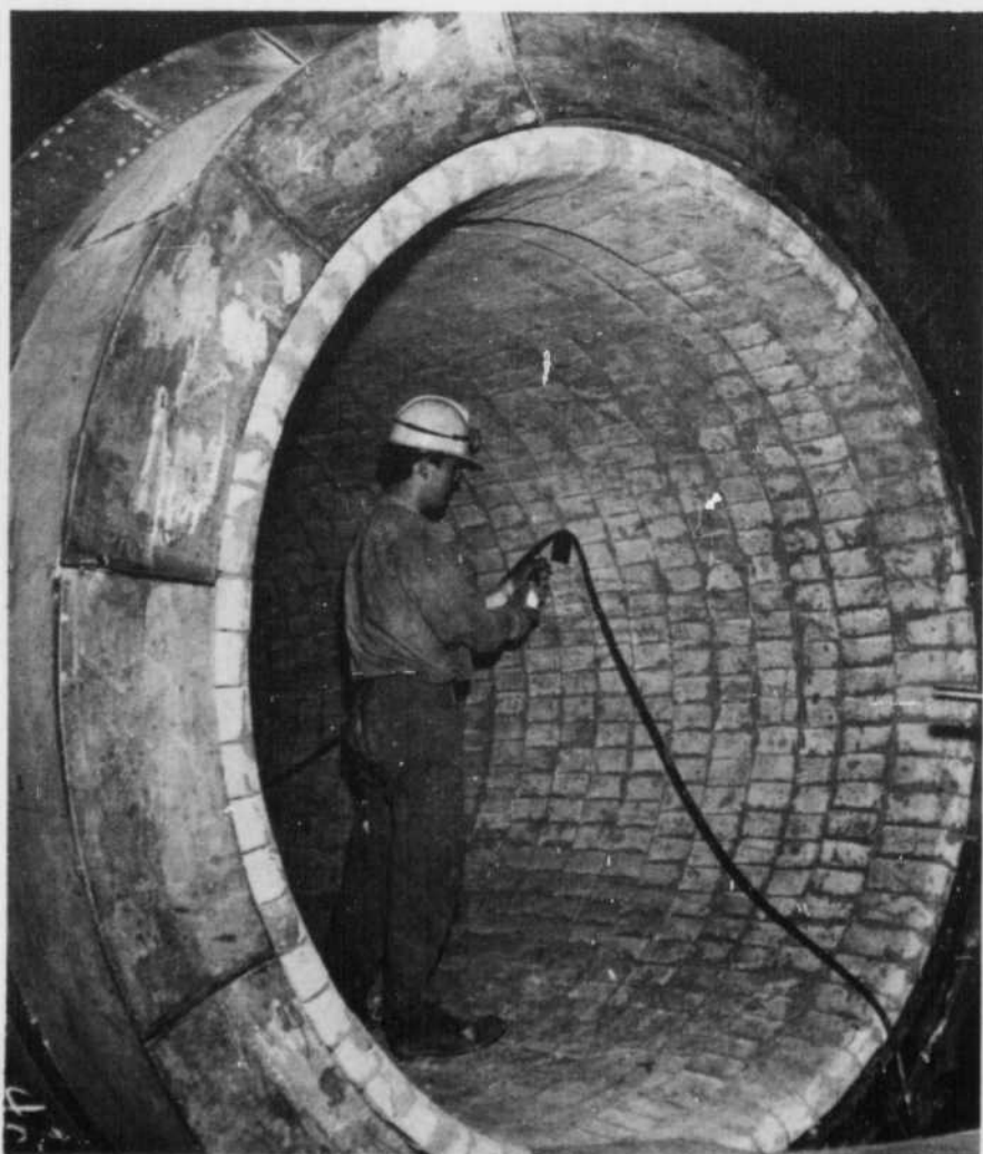
LES FOURS ROTATIFS doivent être régulièrement inspectés. Une chaleur moyenne de 2,200 degrés Fahrenheit doit y être maintenue afin d'assurer la calcination du coke.
