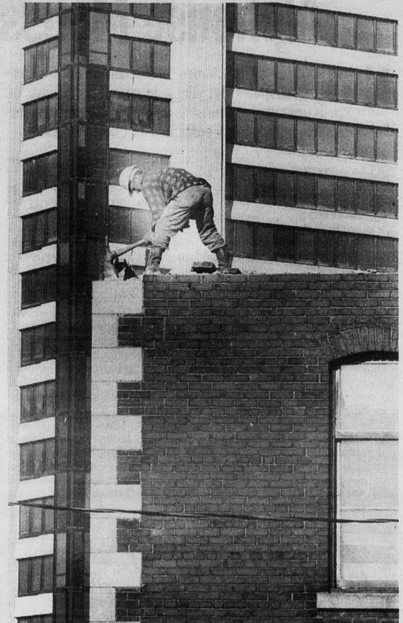
Démolition de certains bâtiments de la rue Principale, en 1972, pour faire place aux édifices fédéraux.
