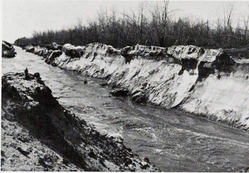
Fossé non protégé. Dommages causés par l'érosion.
