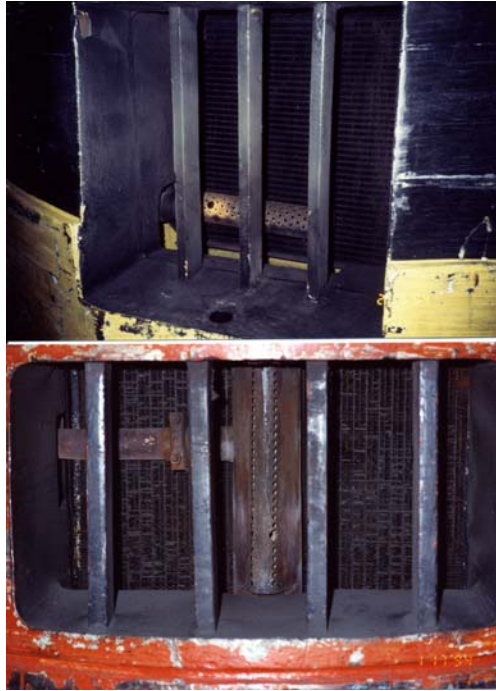
Figure 8 : Conduits particuliers de sortie des gaz d'échappement de chariot élévateur
