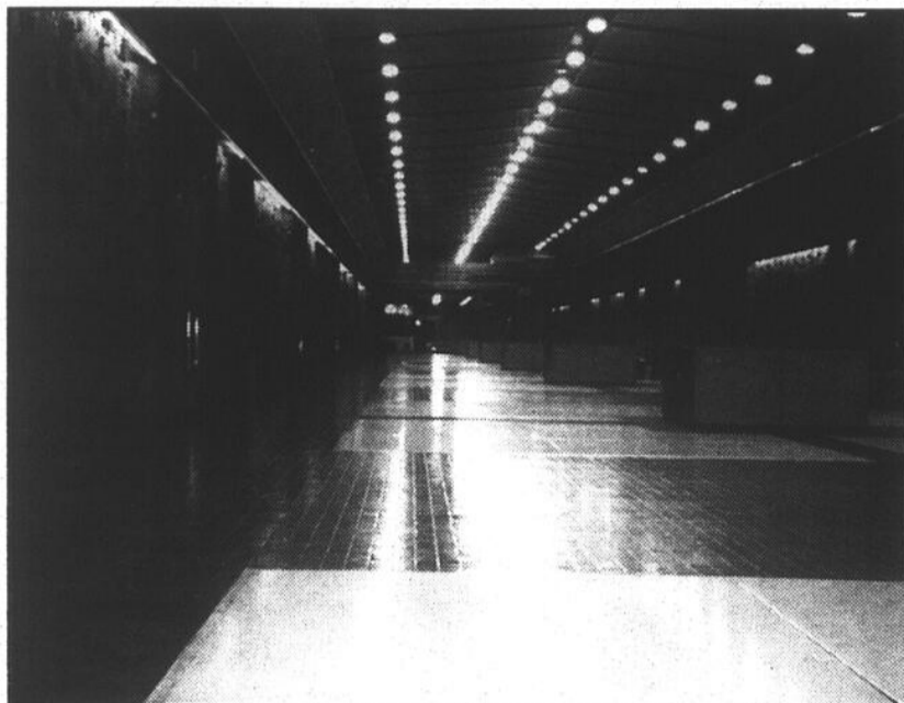
C'est ici, dans les entrailles du bouclier canadien, que se trouve la centrale hydroélectrique souterraine Robert-Bourassa. Cette photo présente la salle des machines.
