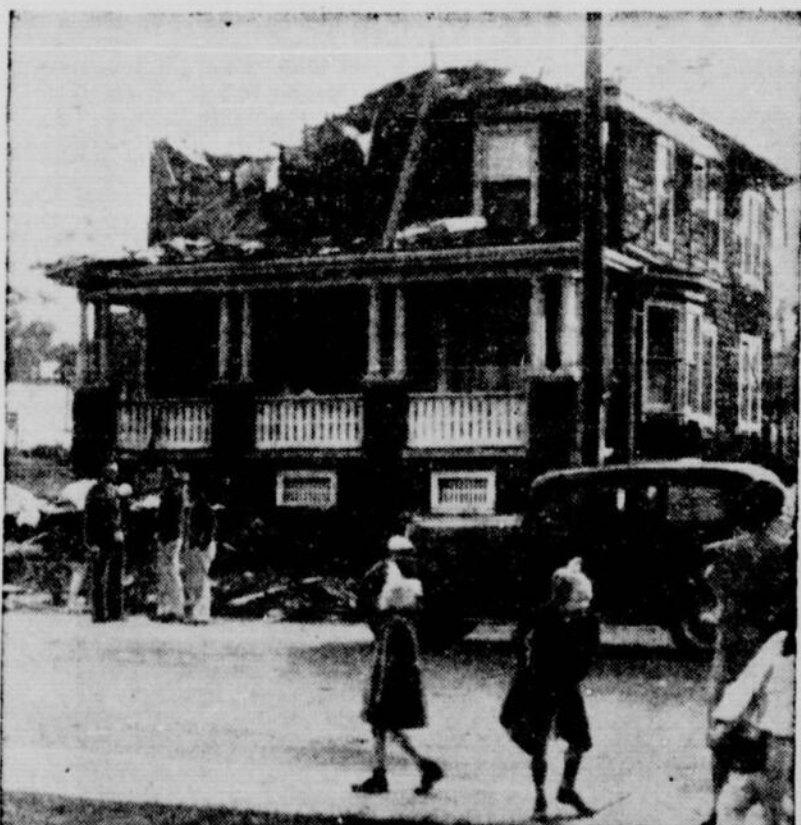
La maison de la famille Morton à Groton, Connecticut, dont un coin fut arraché par un avion. La petite Margaret Morton qui dormait dans la chambre du haut lors de l'accident, s'en tira avec quelques égratignures.
