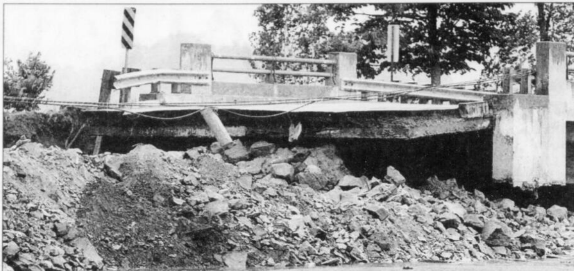
Une portion de la route 307, à Bowman, au nord de Gatineau, a été complètement détruite par le tremblement de terre de mercredi.
